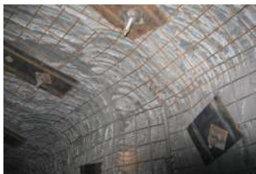
Рисунок 19 – Состояние кровли выработки с анкерной крепью
